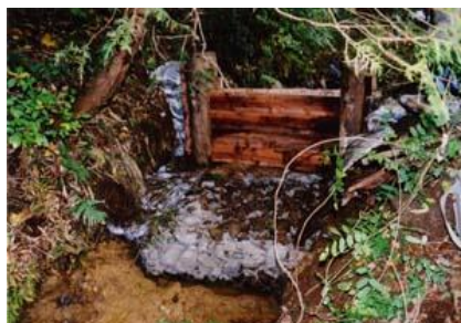
●2007年11月16日 砂川堀に設置された導水用の簡易堰
